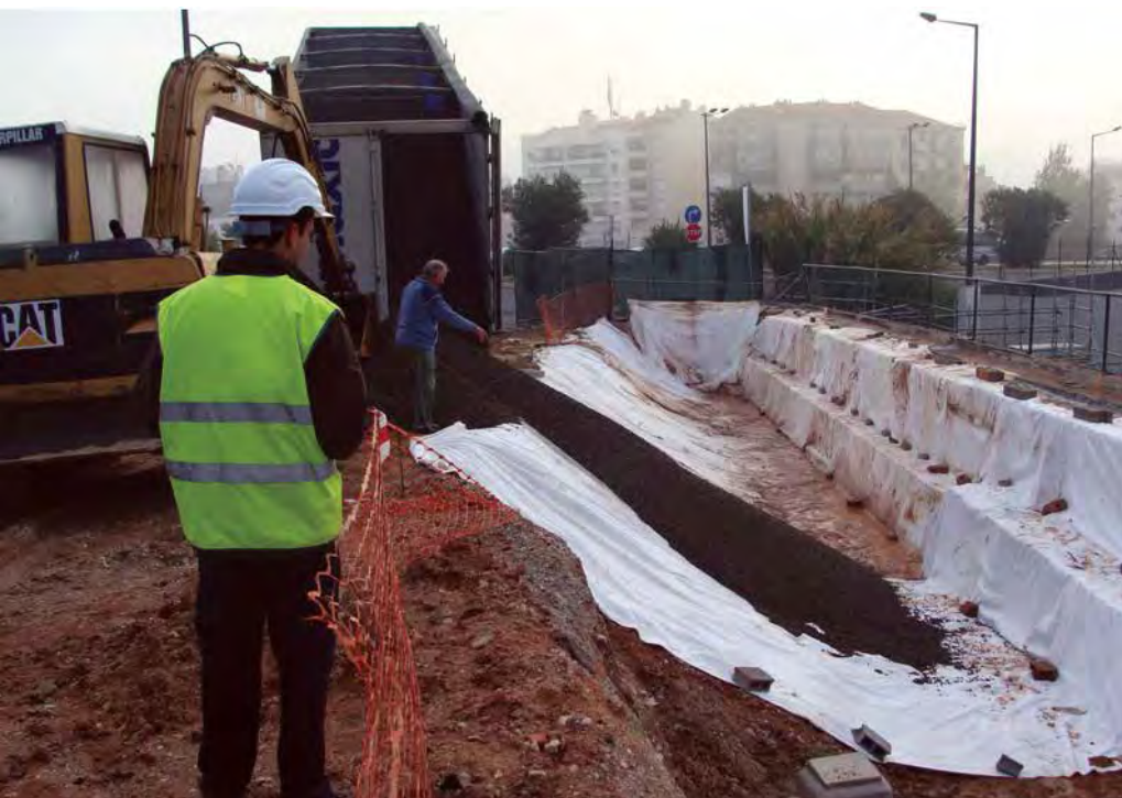
Figura 36 Utilização de Geo Leca® na reabilitação do muro de gabiões que suporta o parque de estacionamento junto à Embaixada dos EUA (Lisboa).
