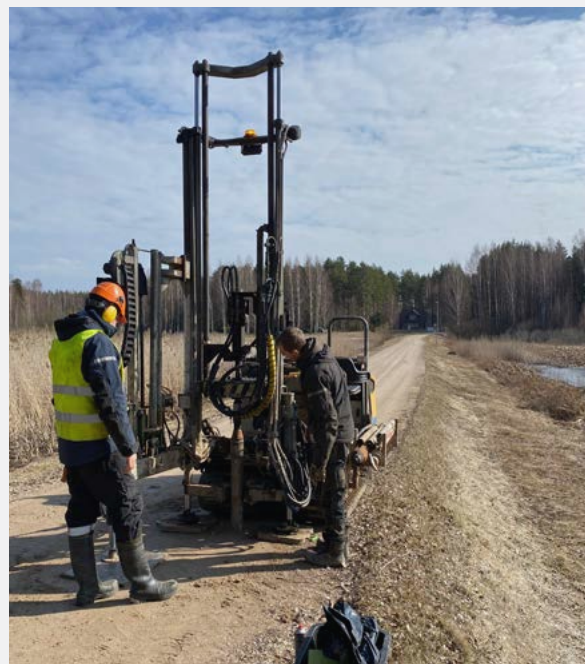
Perfuração de teste em março de 2024 para avaliar a condição do agregado leve Leca® no aterro rodoviário de Varska.
