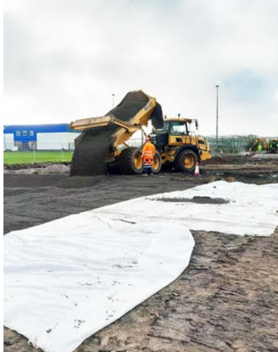
A presença de terreno macio tornou os métodos de construção convencionais inadequados para o projecto.
