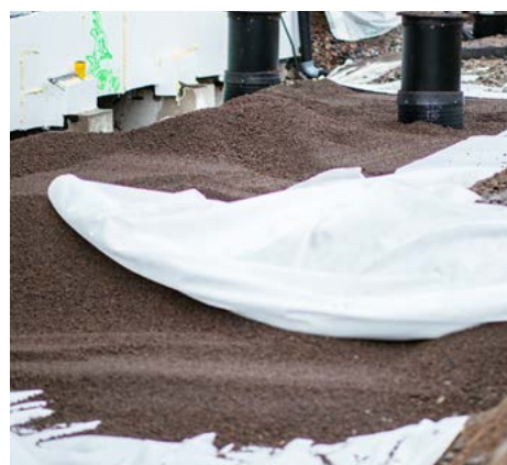
O enchimento leve reduz a pressão do solo em redor do edifício e das infraestruturas.
