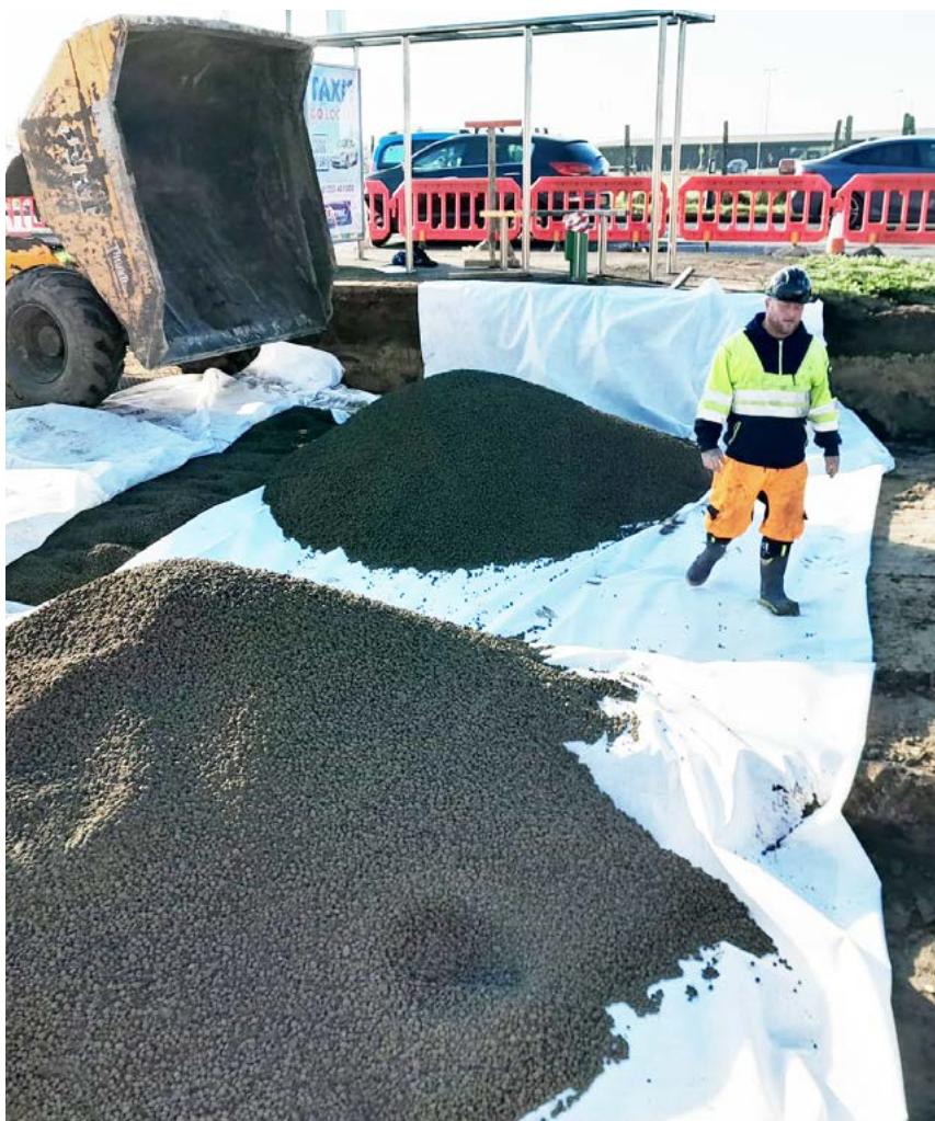
Foram utilizados agregados leves Leca® como material de enchimento leve, reduzindo de forma significativa os assentamentos provocados pelas cargas.
